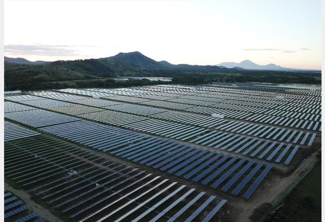
The 35 MW Los Prados plant in Honduras.
